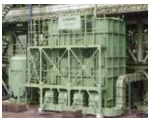
BB形 (生物脱臭塔)
